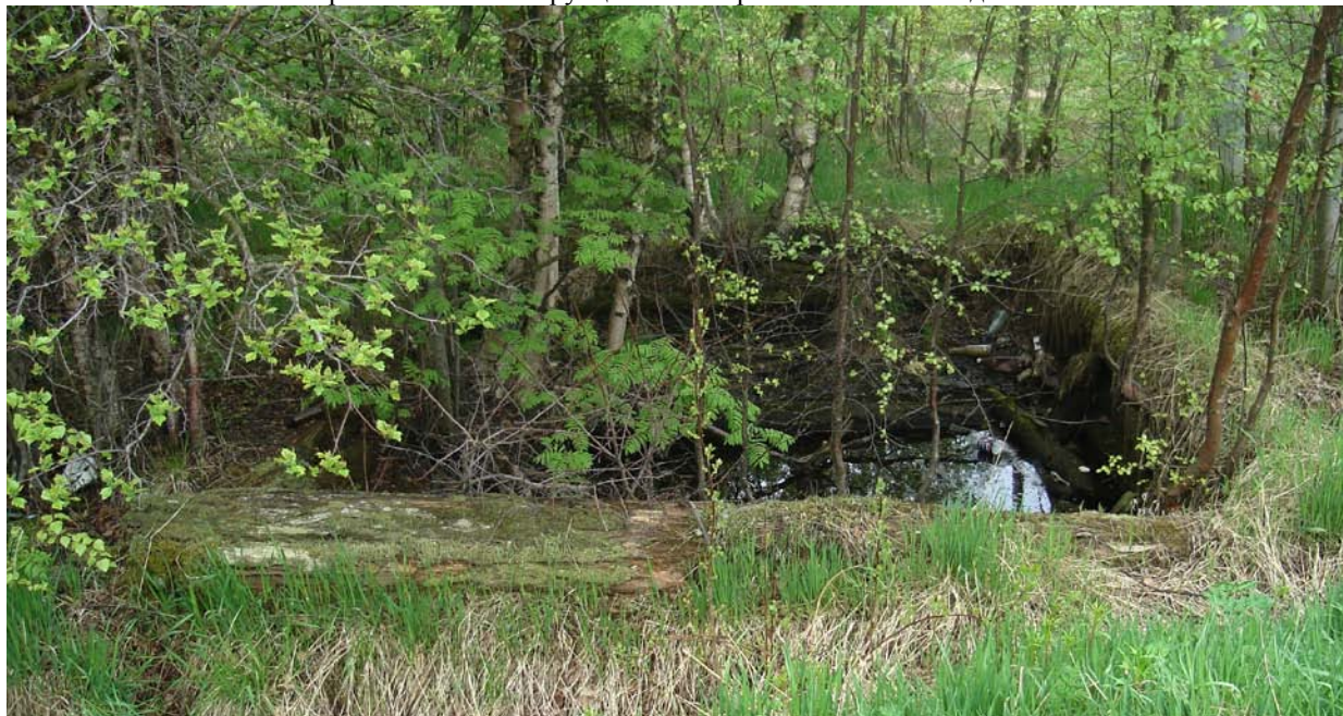
Рис. 69. Остатки бревенчатых конструкций от постройки справа от входа в КПП. Фото 2012 г.
